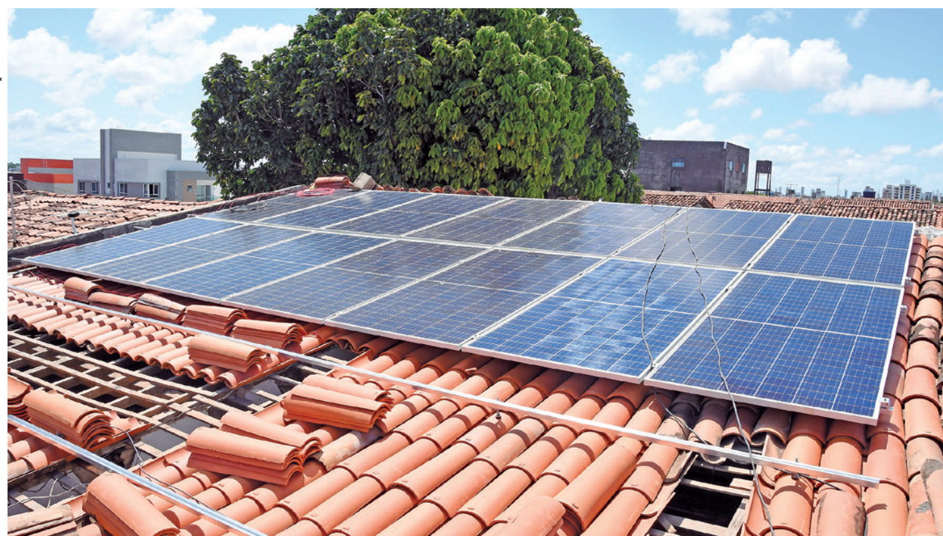
A geração distribuída é caracterizada pela produção de energia em sistemas instalados em telhados ou propriedades privadas
